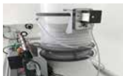
3 Ablufthaube mit Stellglied, Messeinrichtung und Messwerterfassung
